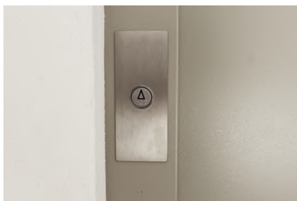
Botonera exterior de la cabina.
